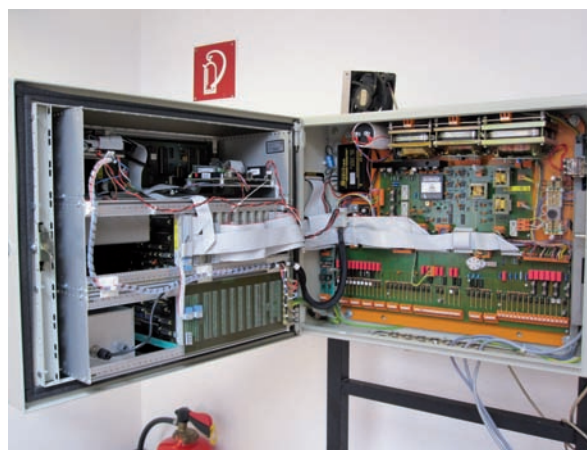
Abb. 5: Zentrale einer TAWES-Station mit der Elektronik. Rechts im Bild sind die Klemmleisten für alle Sensorleitungen, Heizungen etc. zu erkennen. Die Anzahl der notwendigen Kabel war entsprechend hoch.
