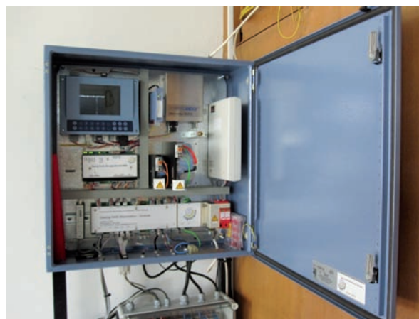
Abb. 6: Zentrale der Stationen TAWES-NEU mit kompletter Verkabelung.
